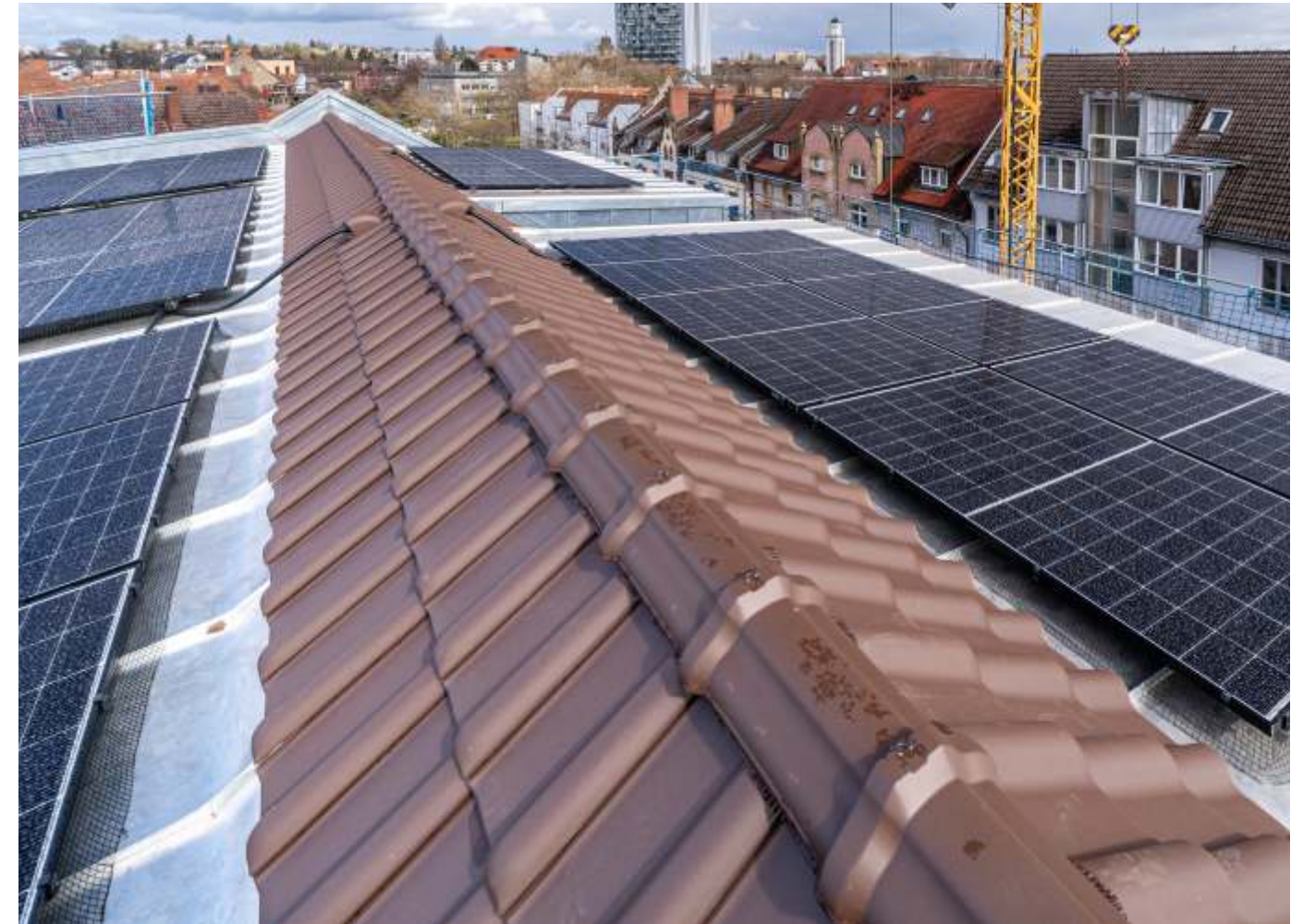
Photovoltaik auf dem neuen Dach Petershauser Str. 5
