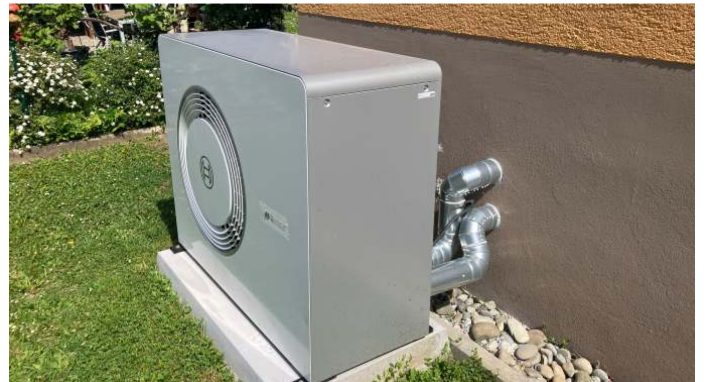
Die Luft-Wasser-Wärmepumpe in der Austrasse 71/73
